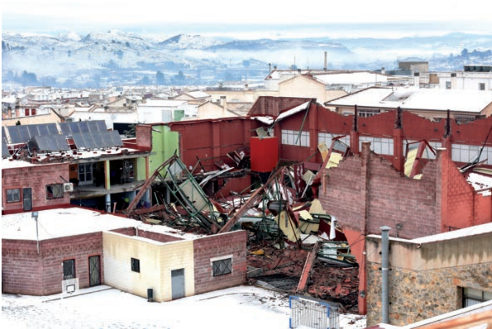
Alfonso Durán. Cehegín, 20.01.2017.- Detalle del pabellón de deportes Loli de Gea, tras derrumbarse la cubierta por el peso de la nieve caída durante la ola de frío que afectó a la región murciana.
